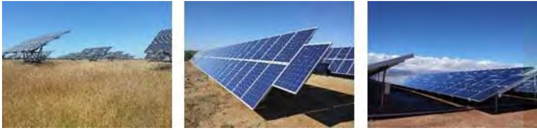
Tipos de estructura fotovoltaica. (a) Seguidor a dos ejes. (b) Seguidor a un eje (horizontal). (c) Fija.
