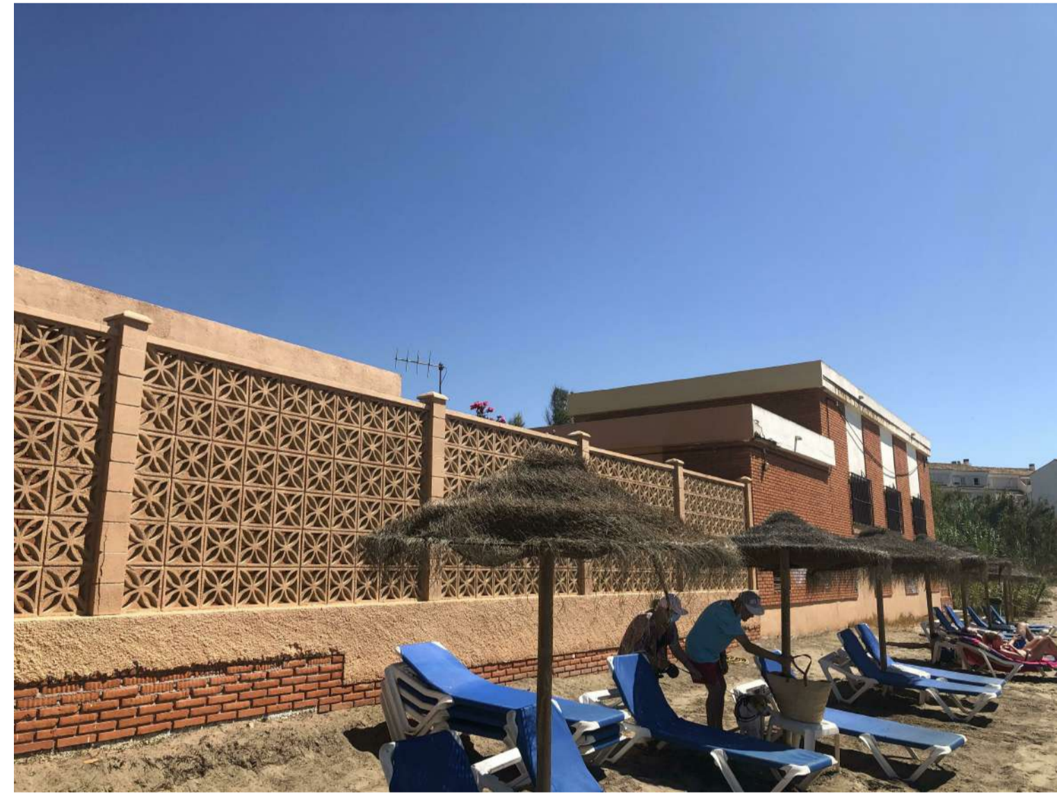
Estación de bombeo de Acosol propuesto para demoler y reubicar en parcela cercana, fuera de la playa (02)
