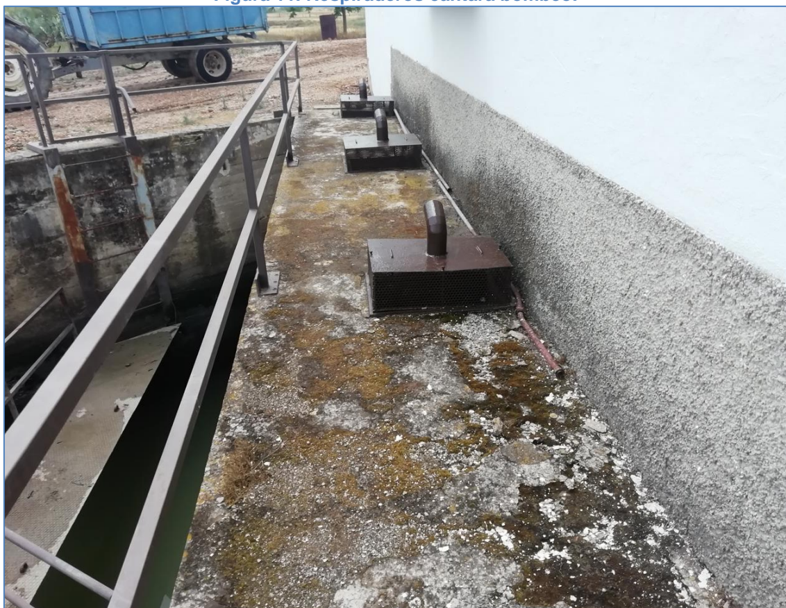
Figura 11. Respiraderos cántara bombeo.
