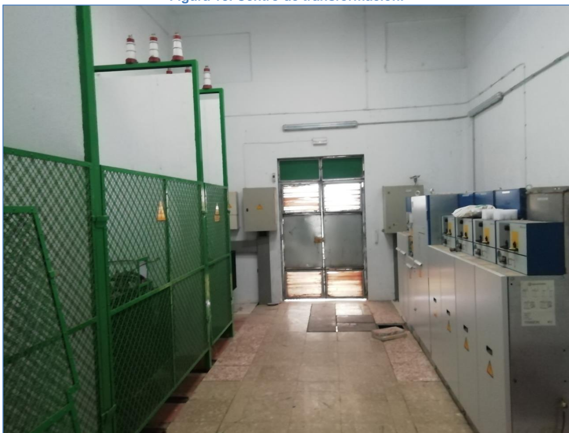
Figura 13. Centro de transformación.
