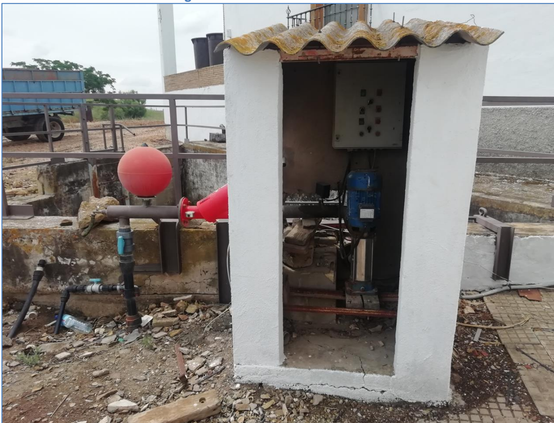
Figura 9. Caseta cántara bombeo.
