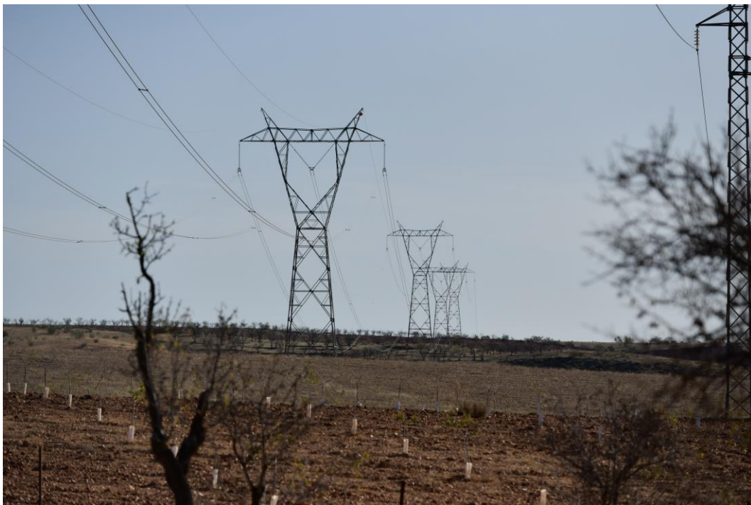
Figura 14. Torres eléctricas en el entorno de los proyectos.
