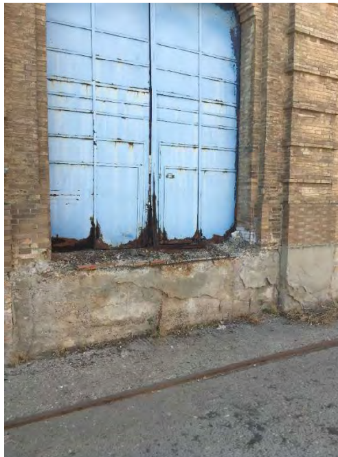
Lateral de la nave 2, con claro deterioro de puerta
