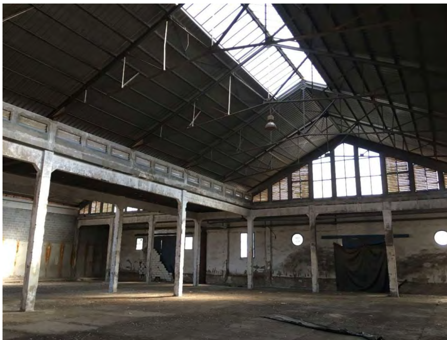
Estado actual de la nave 1, con un claro deterioro y degradación del entorno
