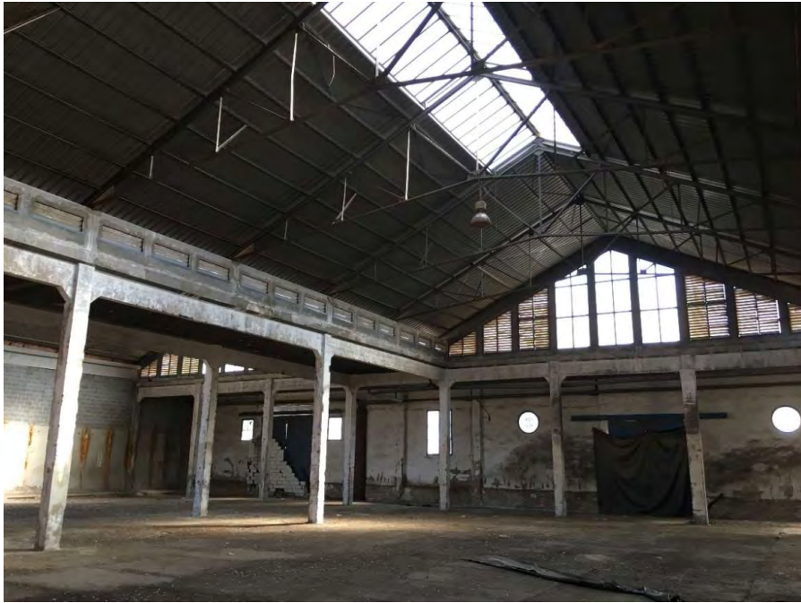
Estado actual de la nave 1, con un claro deterioro y degradación del entorno
