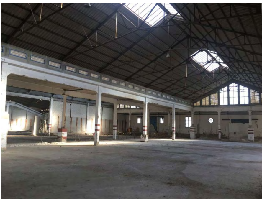
Estado actual de la nave 2, con un claro deterioro y degradación del entorno
