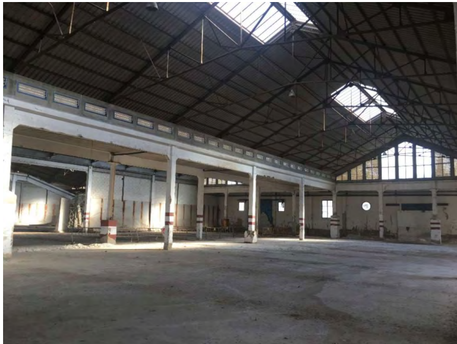
Estado actual de la nave 2, con un claro deterioro y degradación del entorno
