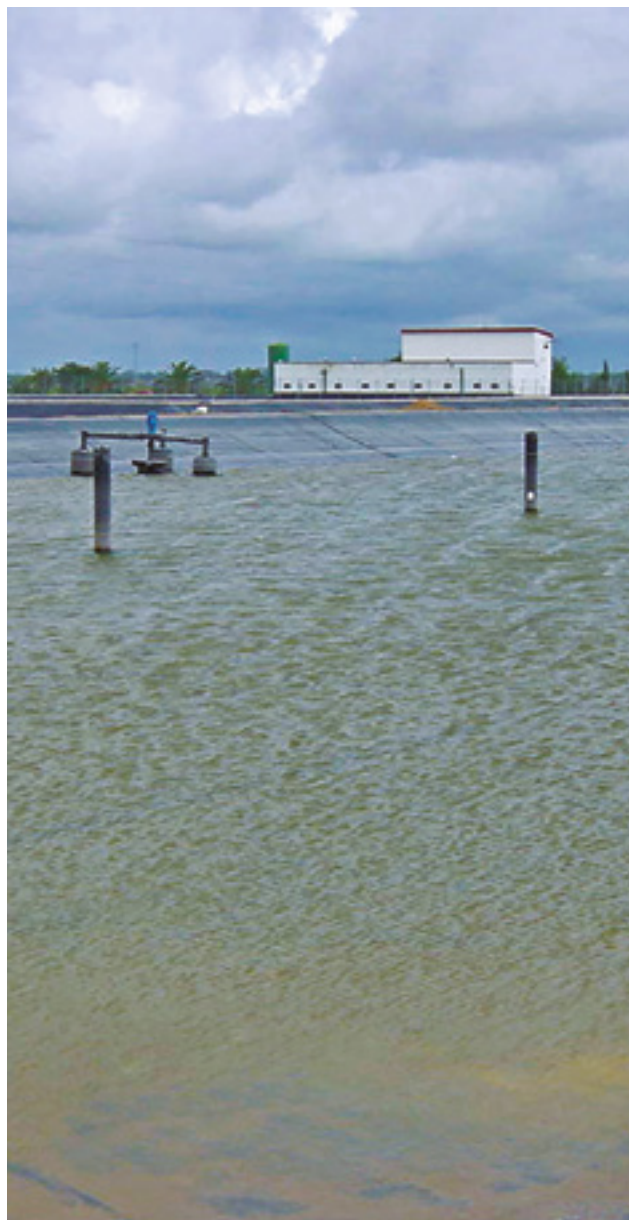
Depuradora de aguas de El Rocío, en el Espacio Natural Doñana
