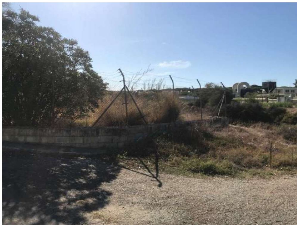
Foto nº 17. Muro y vallado a demoler y a sustituir por talanquera.
