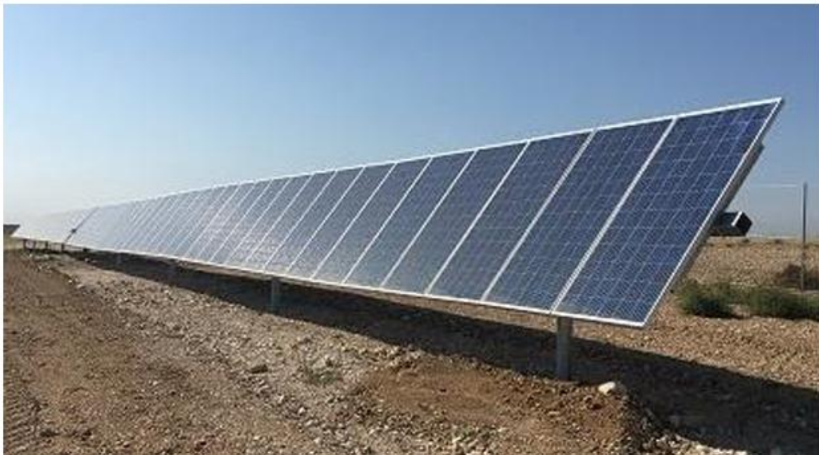
Figura 12. Seguidor solar tipo. Fuente: Proyecto básico de PSFH El Marquesado de 15,75 MW de potencia instalada para la hibridación con el PE El Marquesado, en Puerto Real (Cádiz).
