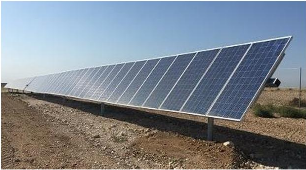
Figura 9. Seguidor solar tipo. Fuente: Proyecto básico de PSFH El Marquesado de 15,75 MW de potencia instalada para la hibridación con el PE El Marquesado, en Puerto Real (Cádiz).
