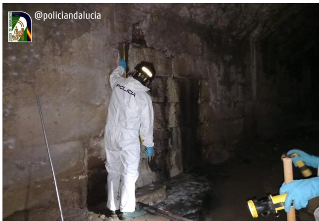
Inspección realizada en el subsuelo urbano por los vertidos realizados en el cauce del río Darro
