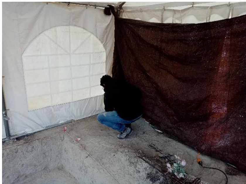
Figura 4.22.- Colocación de rafia en las entradas de la carpa para el aislamiento visual de los trabajos desarrollados.
