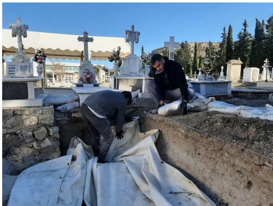
Figura 4.27.- Proceso de tapado con lonas y sacos terreros para evitar la entrada de aguas durante la noche.
