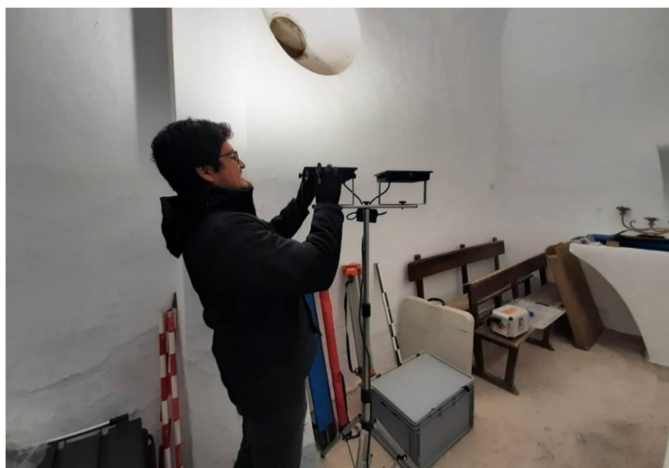
Figura 4.29. , 4.30. , 4.31.- Instalación eléctrica para la electrificación del laboratorio de campo.
