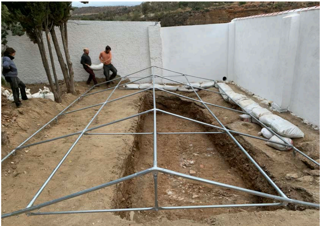
Fig.4.58- Montaje del perímetro de protección para aguas de escorrentía, y primeras fases del montaje de la carpa de protección (5X8 metros)
