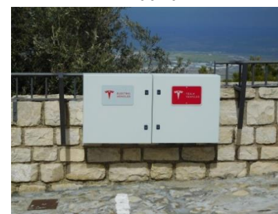
Jaén: Punto de recarga de vehículo eléctrico en Parador de Jaén
