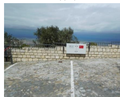
Jaén: Punto de recarga de vehículo eléctrico en Parador de Jaén
