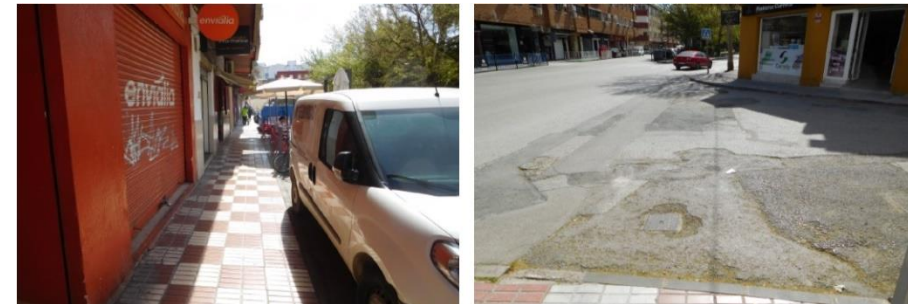
Ilustración 18: Acera estrecha y cruce sin paso peatonal y con pavimento en mal estado. Fuente: Elaboración propia.
