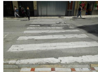
Paso de peatones en mal estado (centro histórico)
