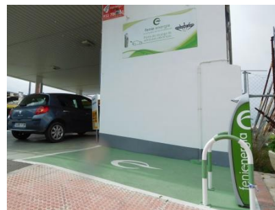
Jaén: Punto de recarga de vehículo eléctrico en gasolinera de Ctra. De Madrid
