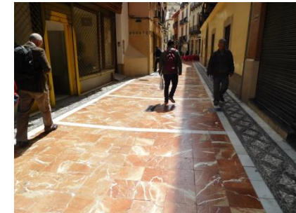
Pavimento deslizante en calle peatonal
