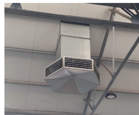
Equipo enfriamiento evaporativo fijo en techo
